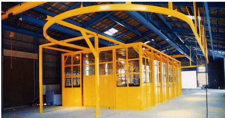
大型ブラスト 大型の型枠や長尺製品などの物件にも対応可能 □広さ：L16m×W7.5m×H4.6m
